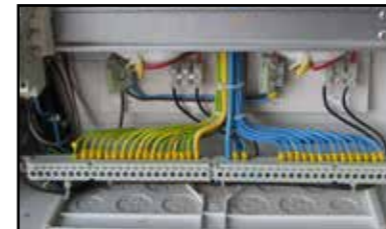
Dostatek prostoru pro kabeláž
